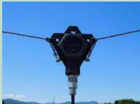
ワイヤーに、balan・同軸ケーブルの荷重がかかる
